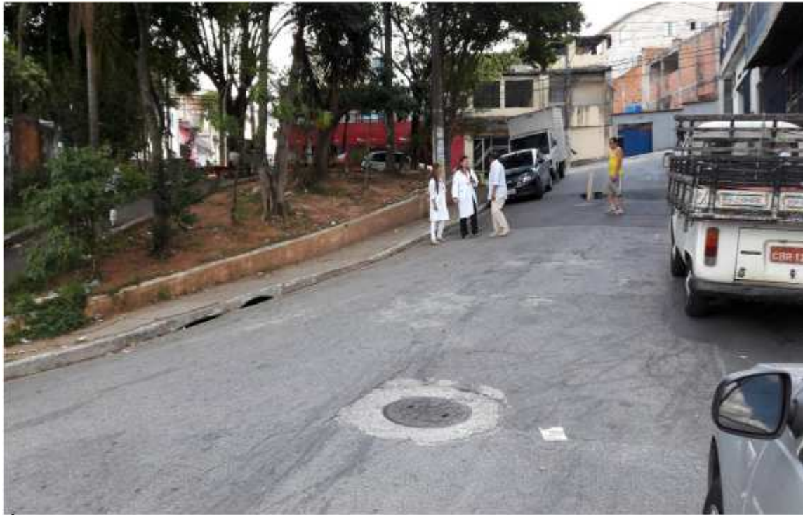
Área de início de solapamento e presença de tampa da Sabesp.
