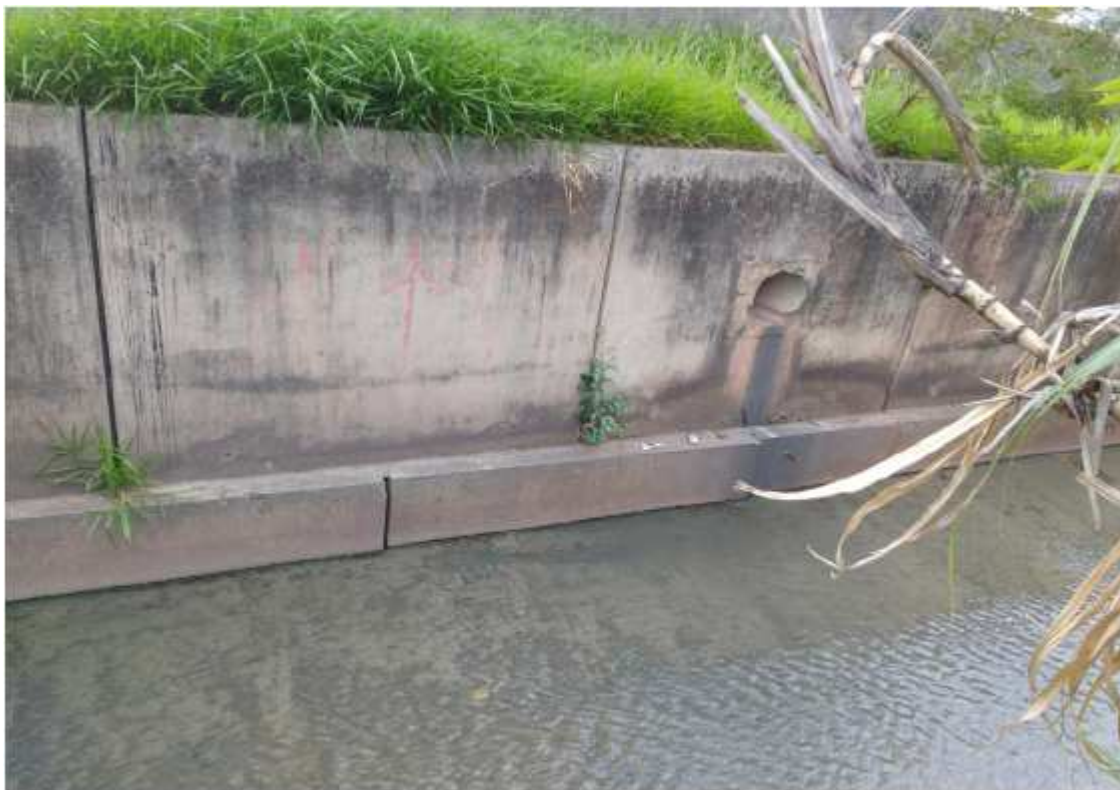
Córrego Tiquatira: presença de cano mas sem evidências de saída de esgoto.
